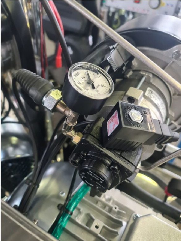
Manómetro de la bomba de gasóleo
