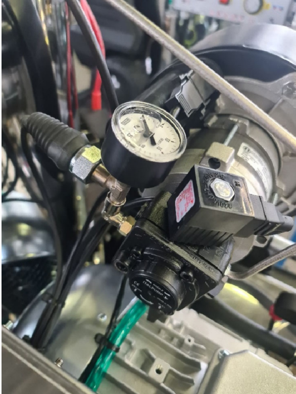
Manomètre de la pompe diesel
