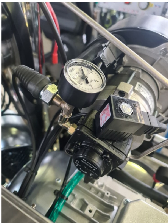
Manómetro de la bomba de gasóleo
