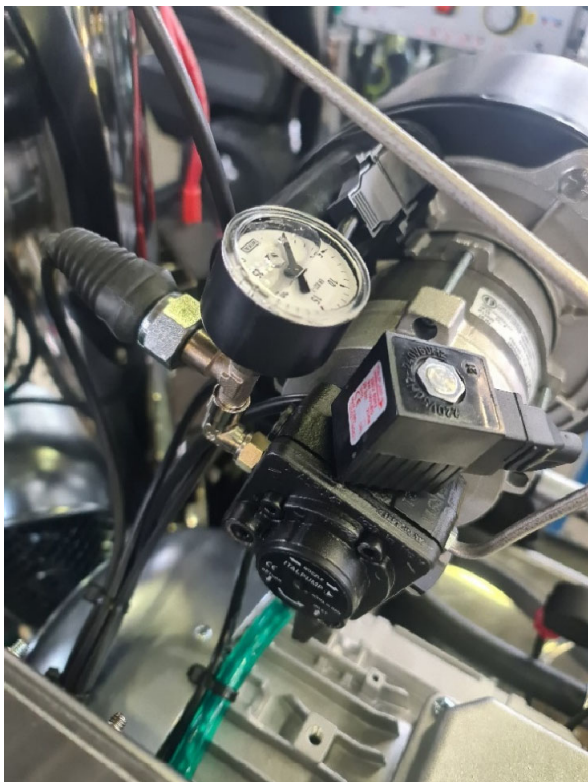
Manometro pompa Gasolio
