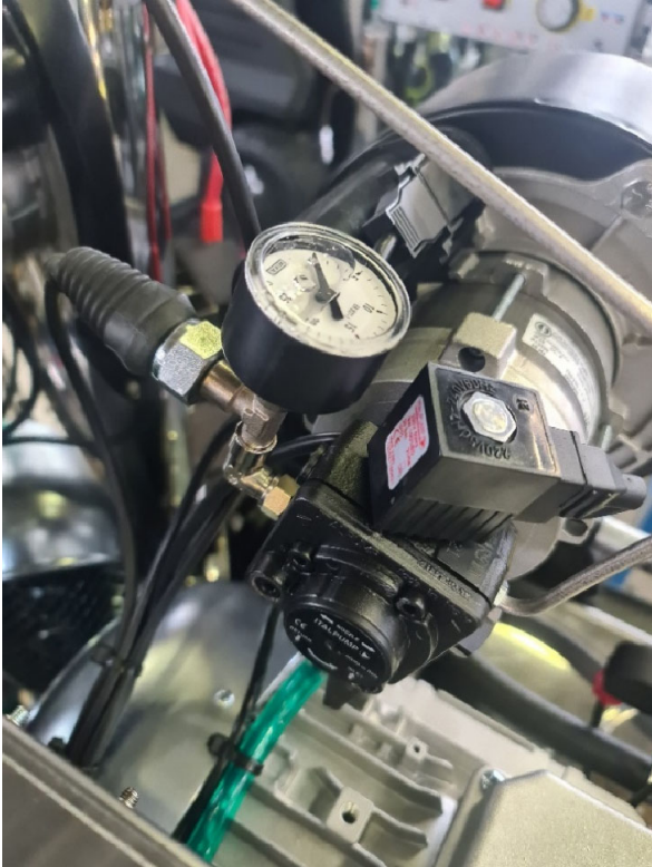
Manómetro de la bomba de gasóleo
