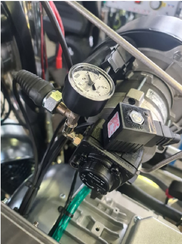
Manomètre de la pompe diesel
