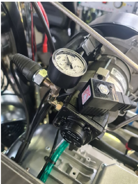
Manomètre de la pompe diesel
