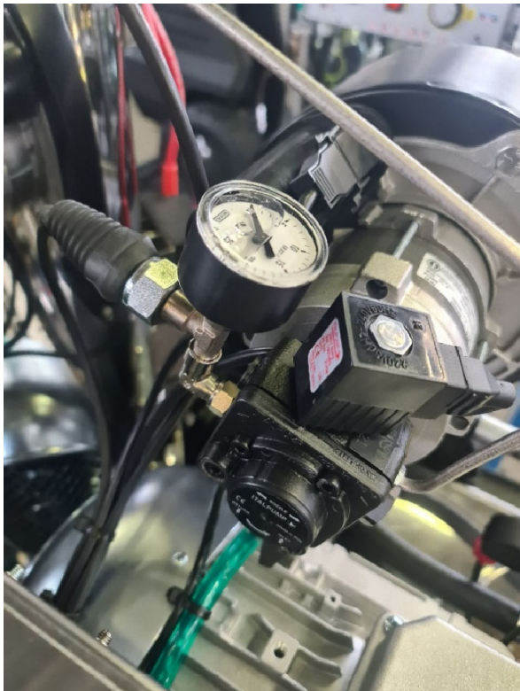
Manómetro de la bomba de gasóleo
