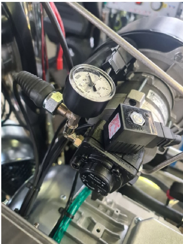
Druckmanometer für die Heizölpumpe Heizölauslasses
